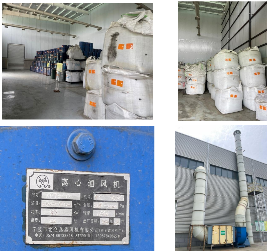
图 4.1-1 贮存车间负压引风系统、活性炭吸附装置
