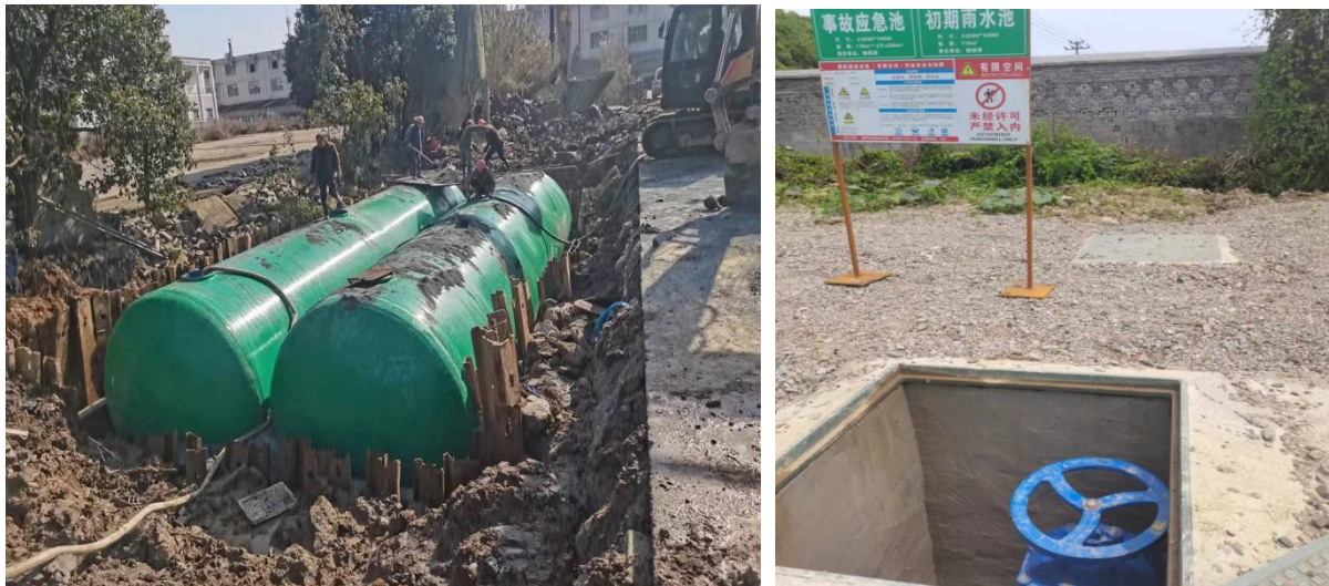
图 4.2-2 事故应急水池及切换阀
