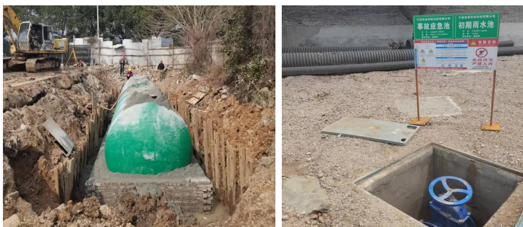
图 4.1-3 初期雨水池、切换阀
