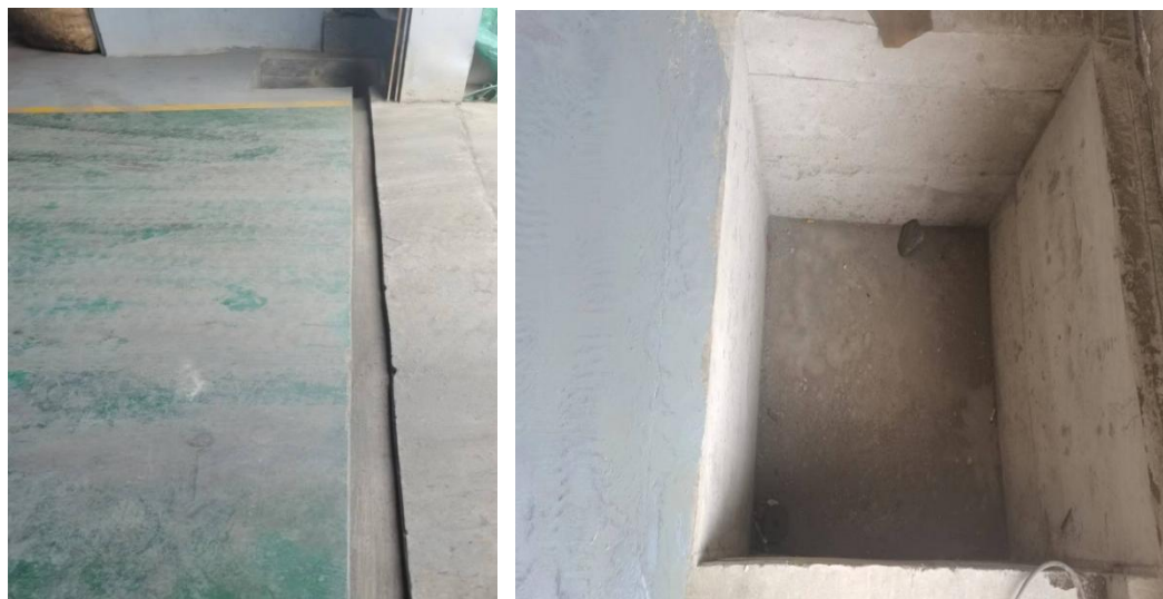
图 4.1-2 仓库各车间设置的导流沟、收集池
